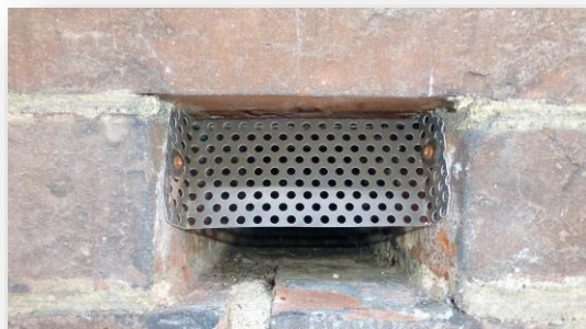
Buca pontaaia parzialmente ostruita per permettere la nidificazione dei rondoni (in alto) ed escludere i colombi.
