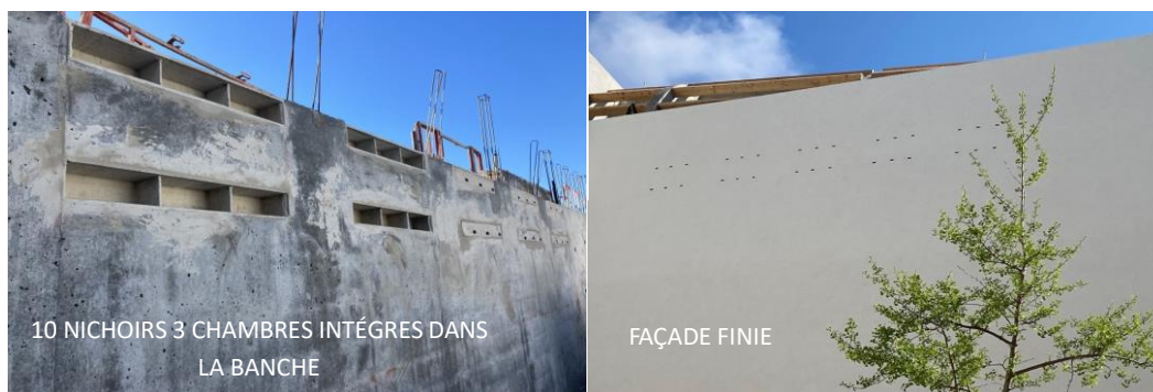
Figure 20 : Photographies de nichoirs intégrés dans un mur coulé en béton sur un bâtiment de la ville de Nice © Olivier Winock – Nath'H.
